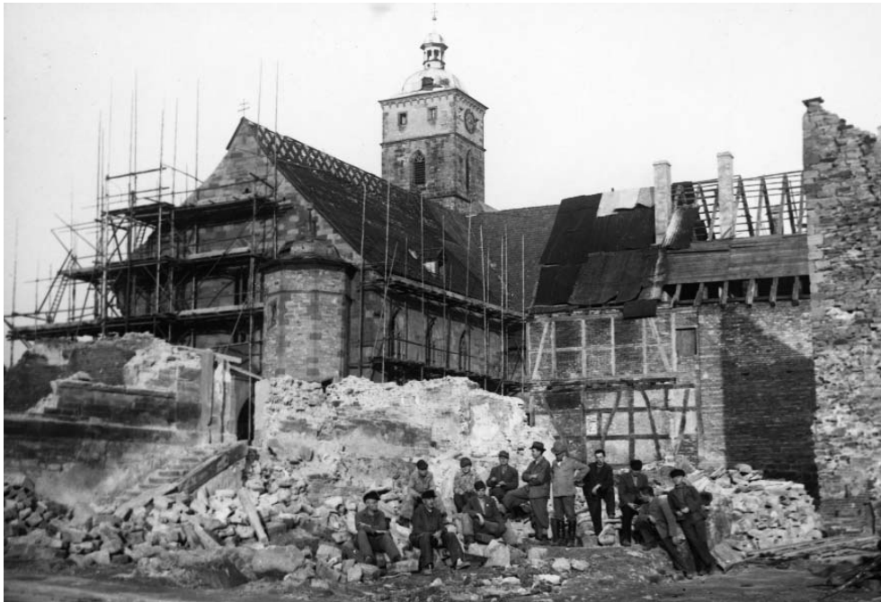
Schutträumen im Schatten der schwer zerstörten Kirche St. Johannes.
